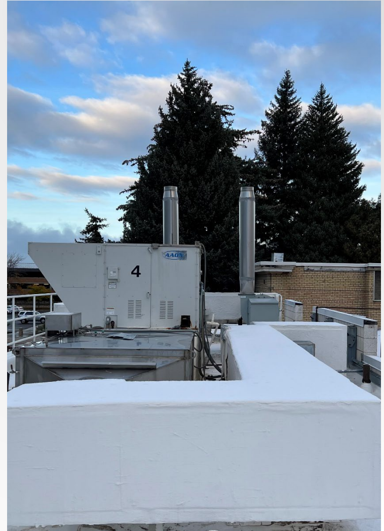
Stack Fan System
